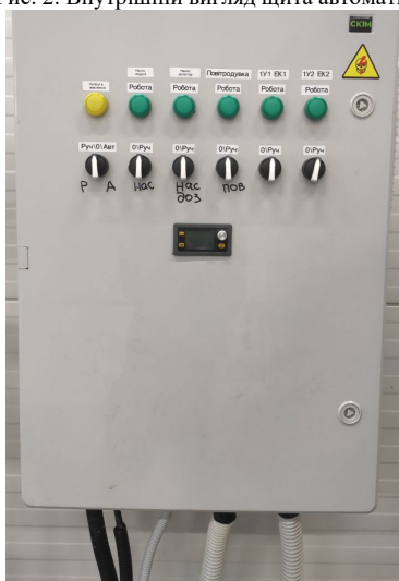
Рис. 3. Зовнішній вигляд щита автоматизації
