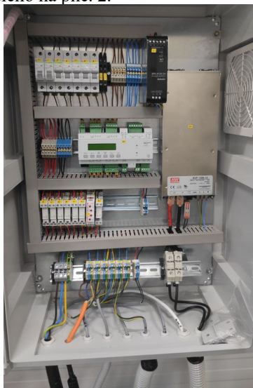
Рис. 2. Внутрішній вигляд щита автоматизації
